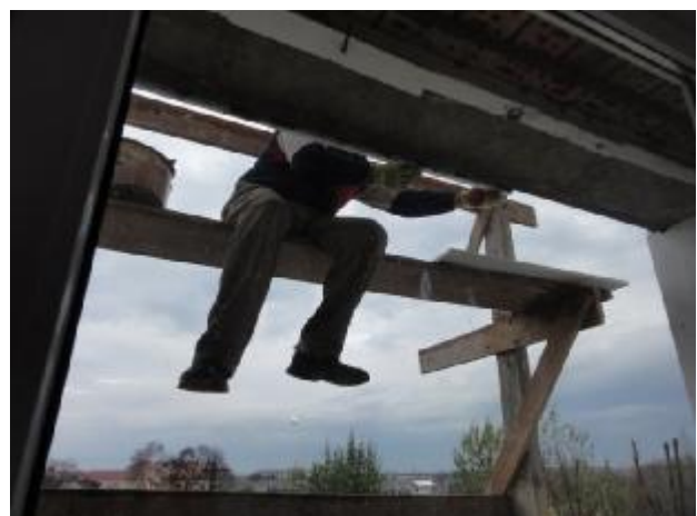
frei sitzend auf dem Gerüst ( SUVA konform?)
